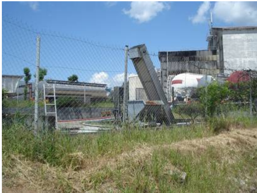
2- Poste de dégrillage et refoulement des effluents (cave coopérative)
